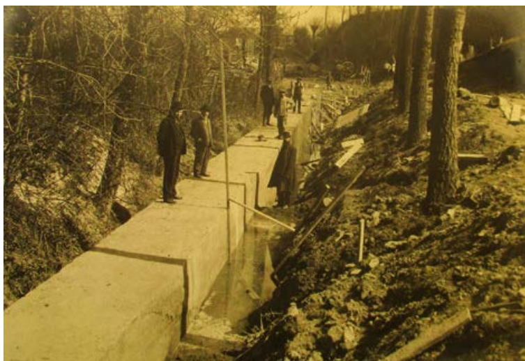
FIGUUR 3 Aanleg waterleiding naar Heerlen bij de Zevensprong (archief: Hary van Aken).
